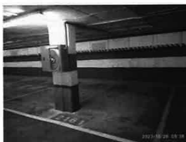
Adequació xarxa contraincendis
