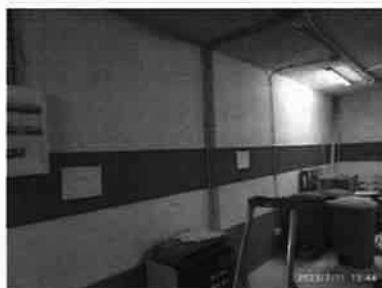
Reforç de lluminàries zona bancs de treball
